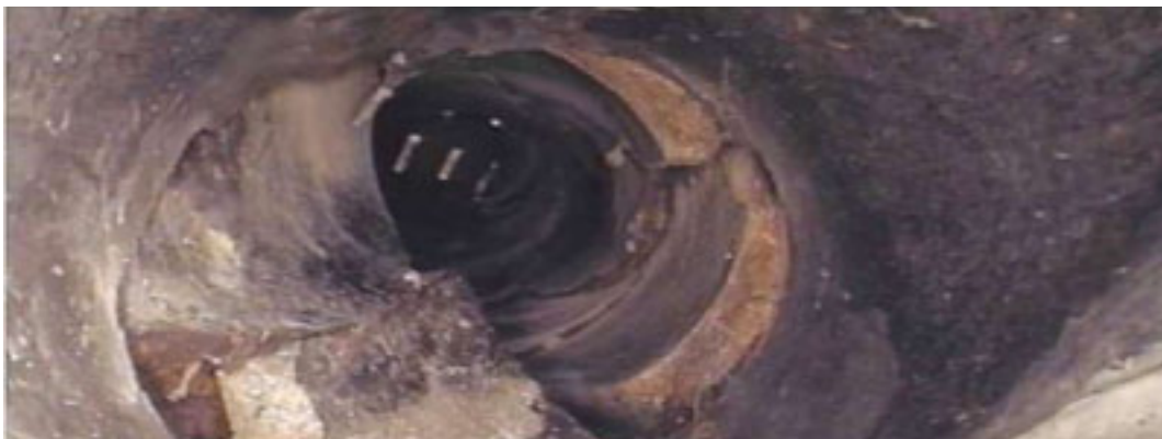
Blick durch die Kamera in einen schadhafte Abwasserkanal.
